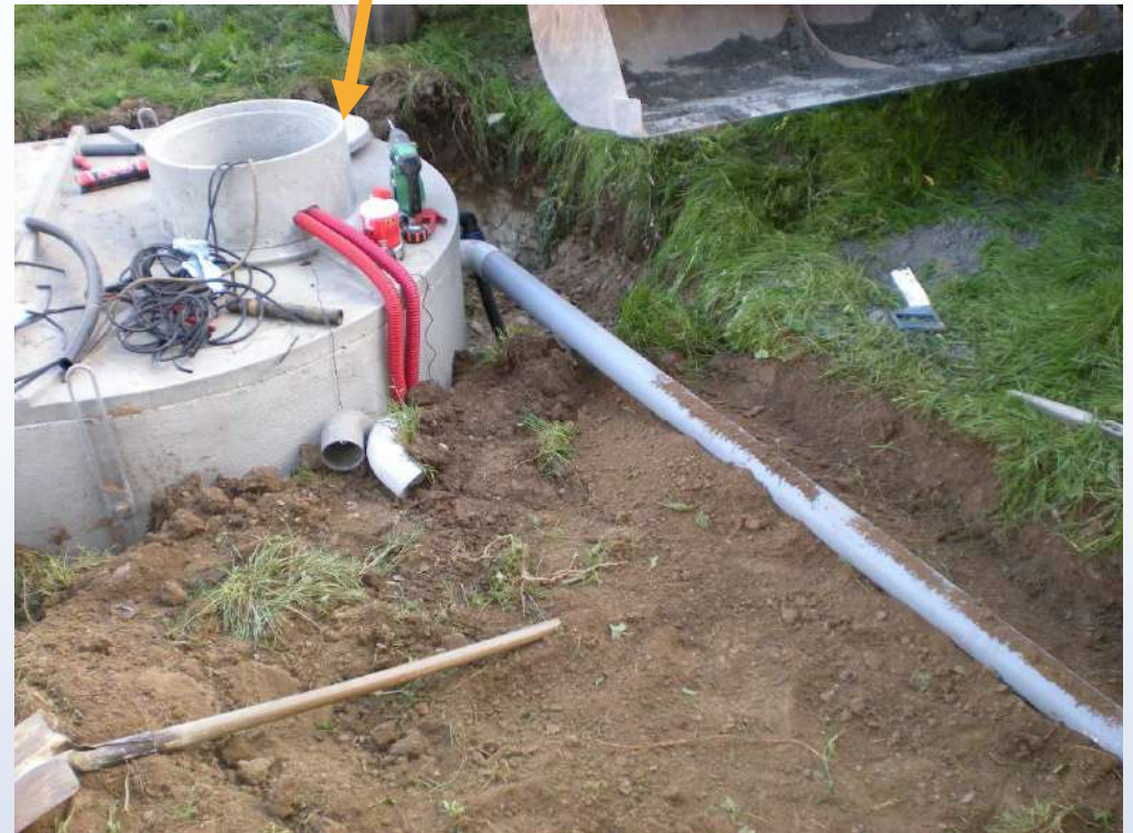
Cuve béton avec réhausse.
